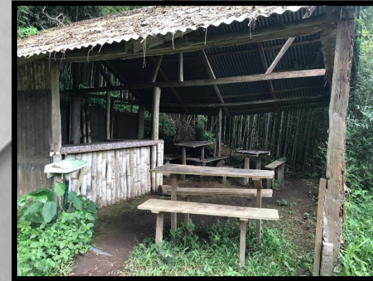
Infraestructura en mal estado
