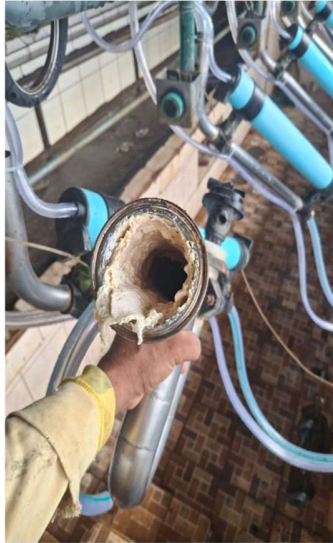
Figura 8. Evidencia de depósitos y residuos en las tuberías del sistema de ordeño
