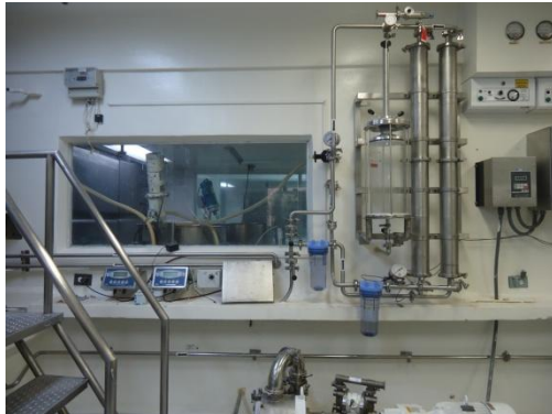
IMAGEN 86. Vista desde cuarto de máquinas a producción, ICP
