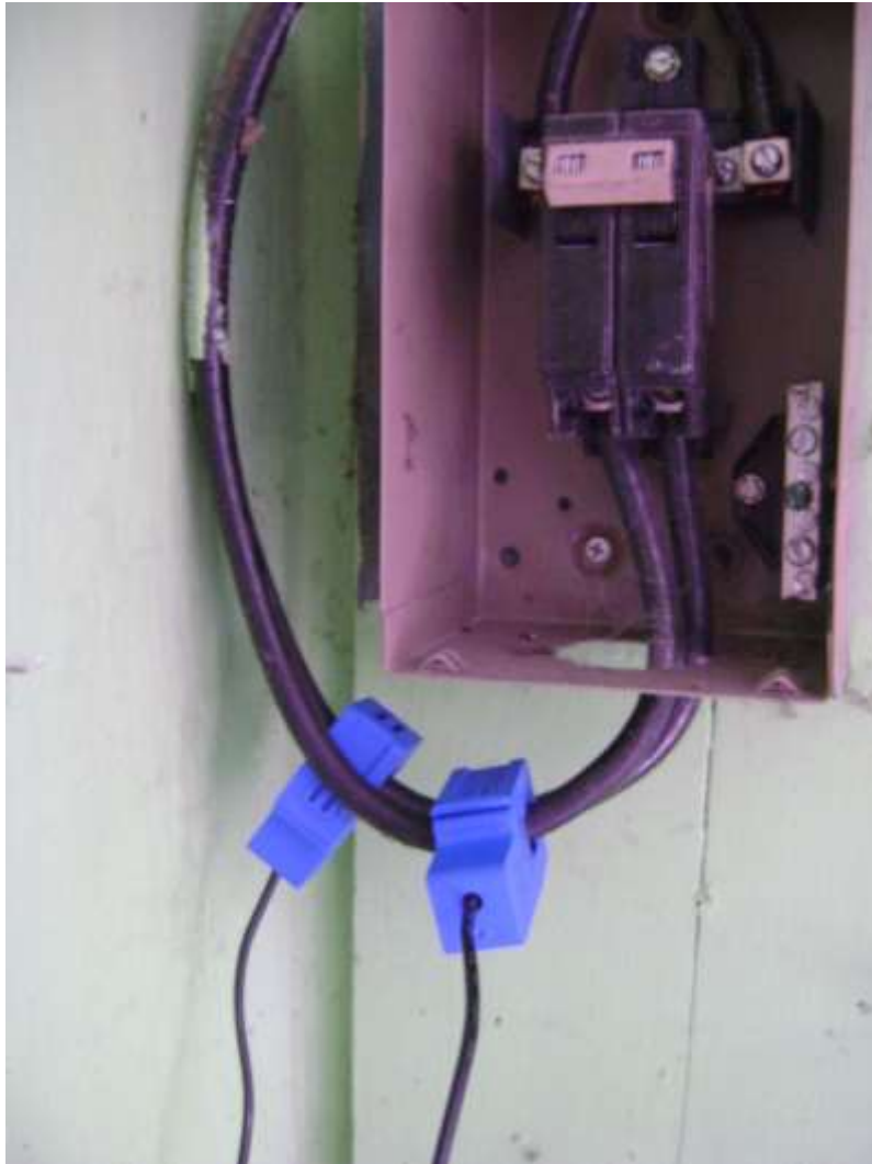
Figura 68. Conexión Sensores de Corriente a la Red Eléctrica
