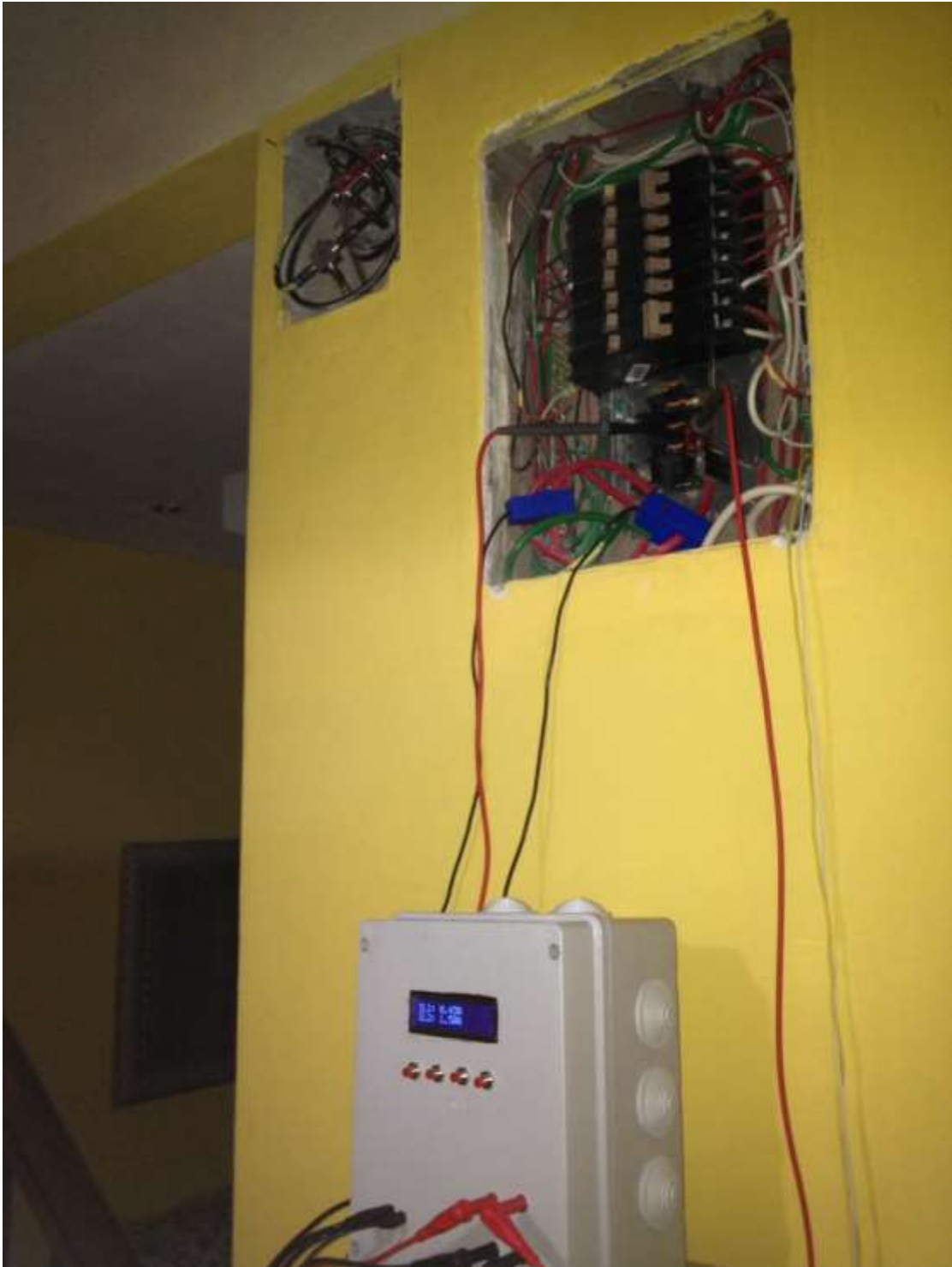
Figura 52. Sistema Instalado en la Red Eléctrica Residencial
