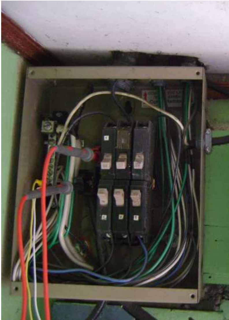
Figura 69. Conexión para la Medición de Tensiones
