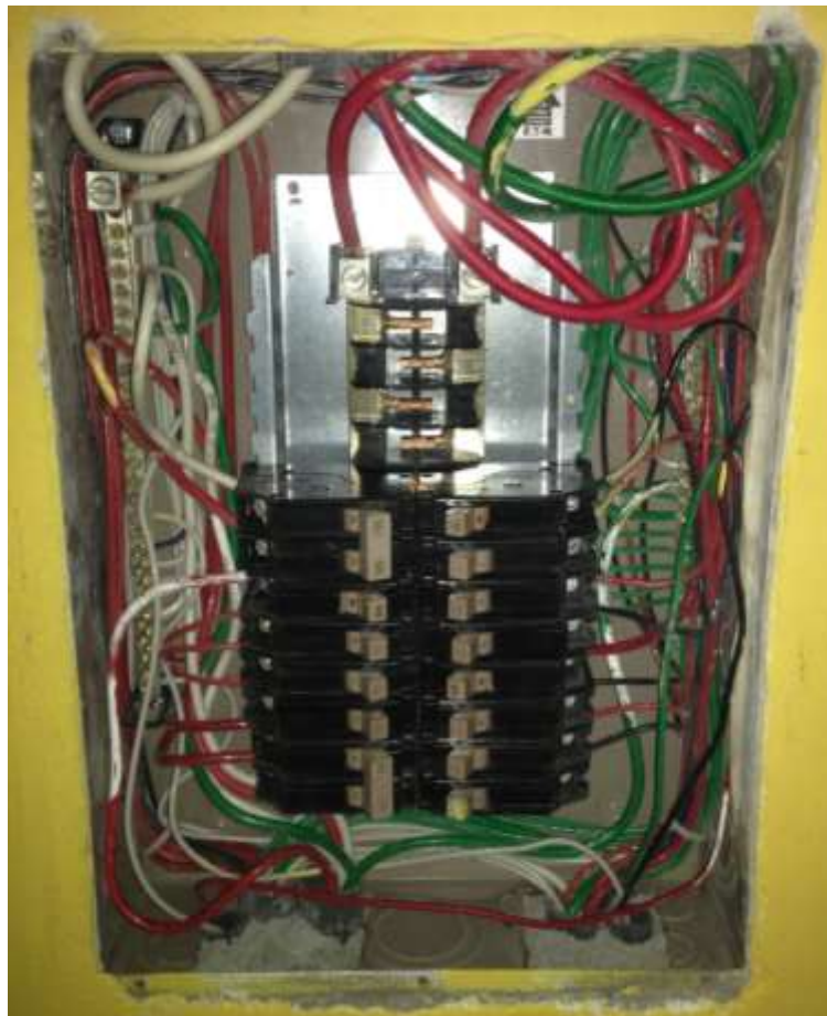
Figura 16. Red Eléctrica Monofásica
