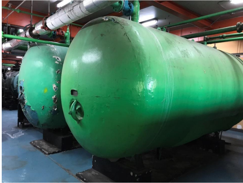
Figura 4: Tanques generadores de agua caliente
