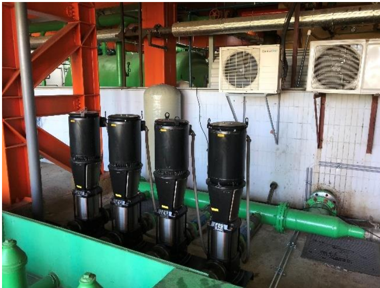
Figura 6: Bombas de suministro de agua potable
