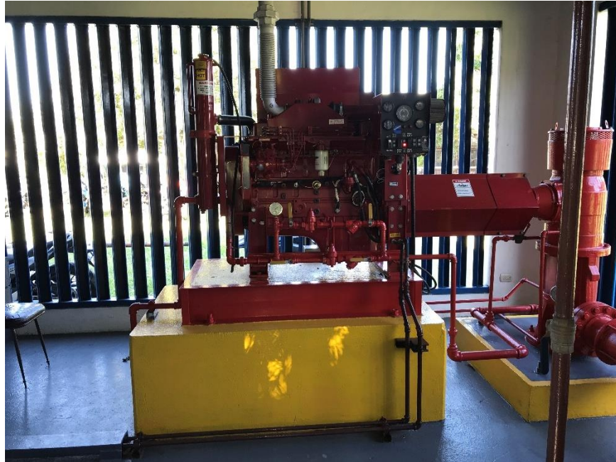
Figura 7: Sistema de respuesta contra incendios
