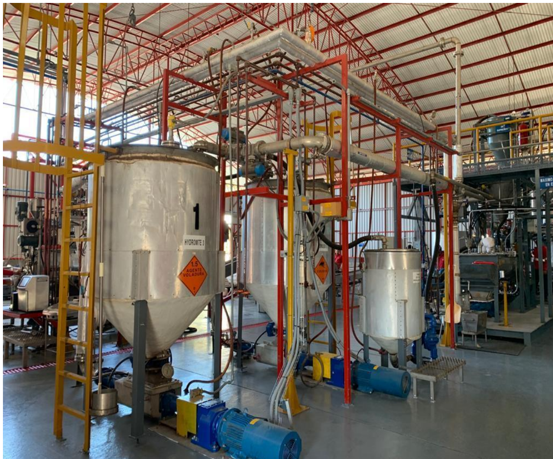
Figura 1: Vista de los tanques de hydromite y el otro de Emulex,
