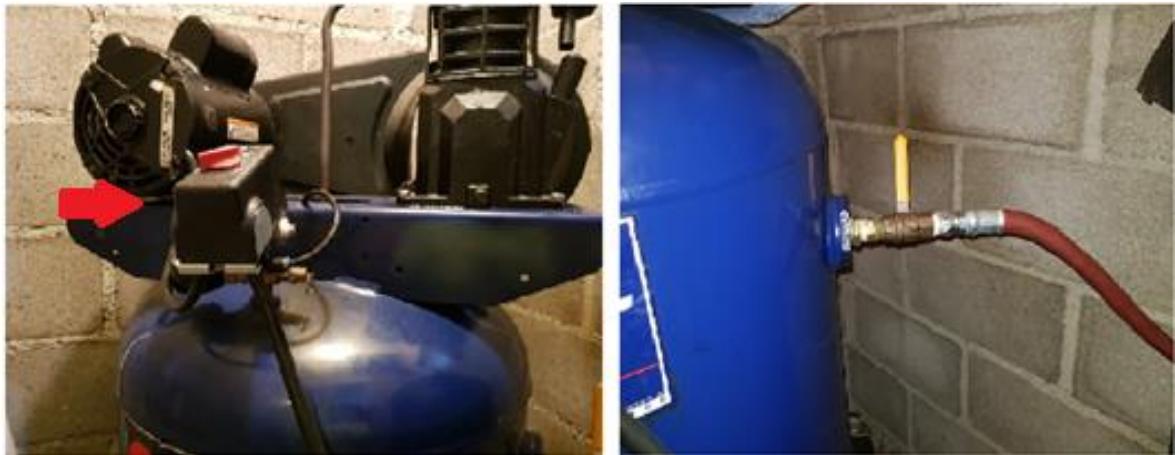
Figura 17. Activación manual del compresor neumático
