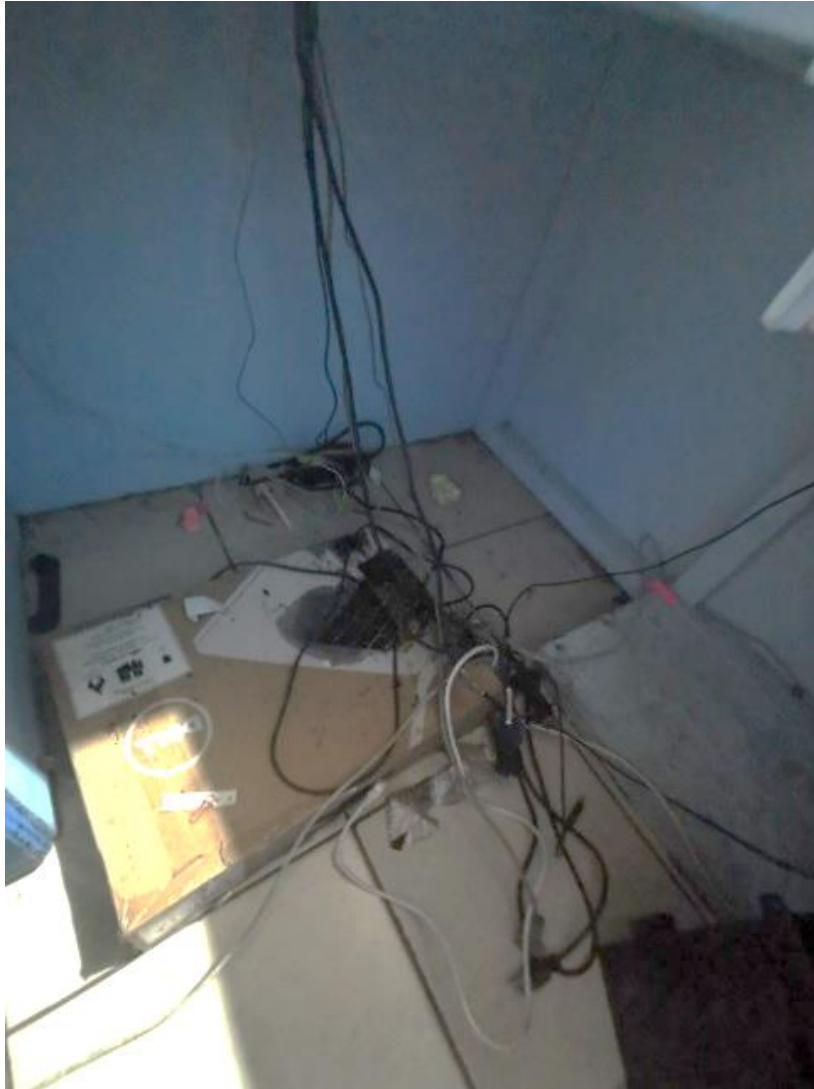
Figura 27 - Instalación en sucursales
