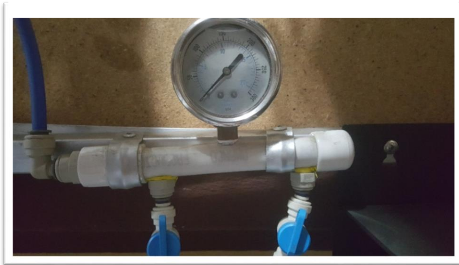
Figura 23 Elaboración de manifold.
