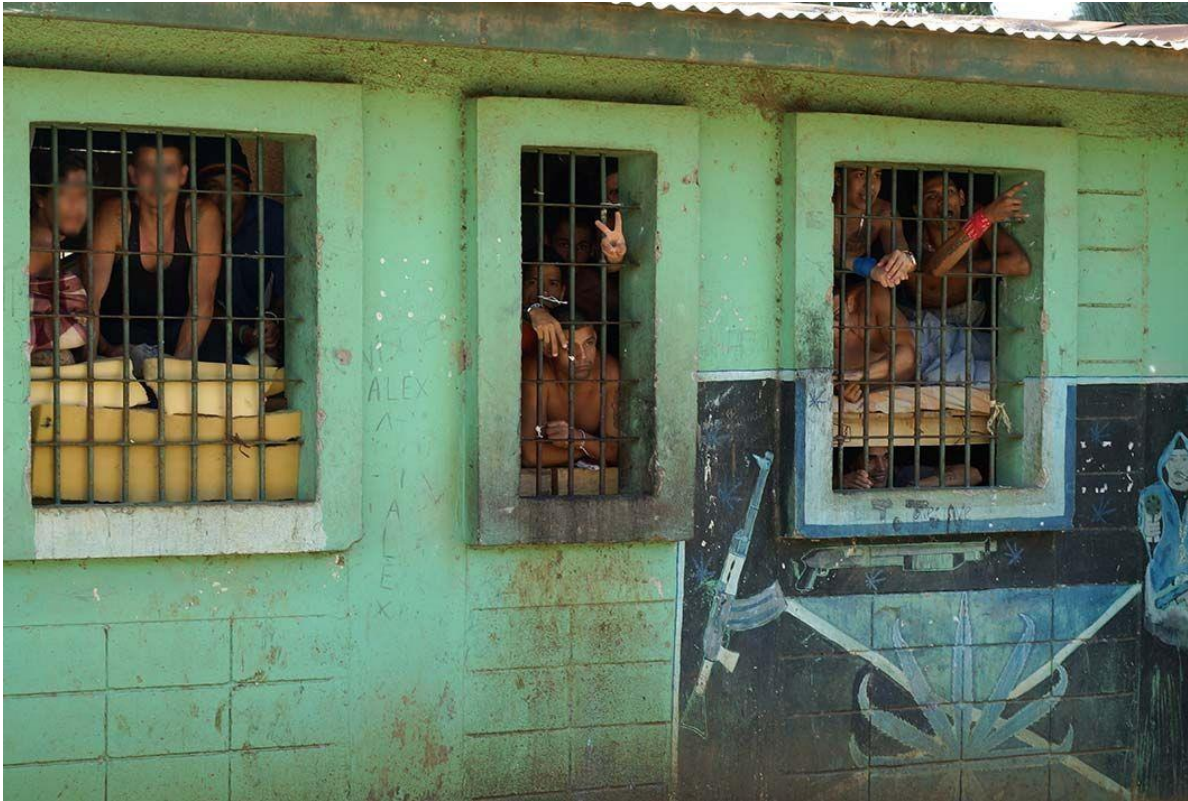
Fotografía N°4 Obtenida del medio de comunicación La Extra. En la presente se demuestra lo deteriorado que se encuentra la estructura de los centros penales, así como el ambiente sucio que se encuentran los privados de libertad.
