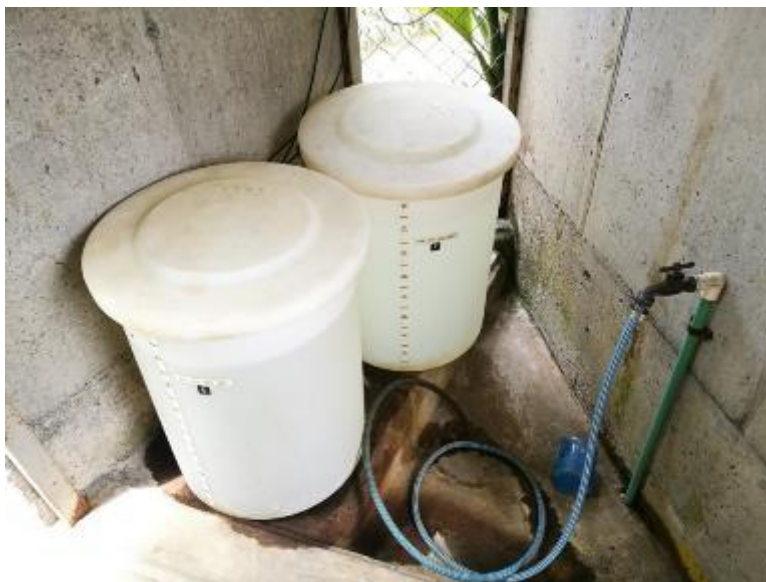
Figura 17 Tanques externos de químico fijador y revelador Fuente: Elaboración propia Clínica de Coronado
