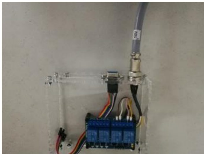
Figura 62 Conector de señales de los relés Fuente: Elaboración propia.
