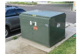
Img. 148 Celda de medición de voltaje
