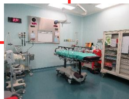
Img. 131 Sala de Choque
