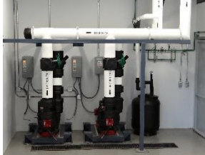
Img. 105 Sistema de Chiller
