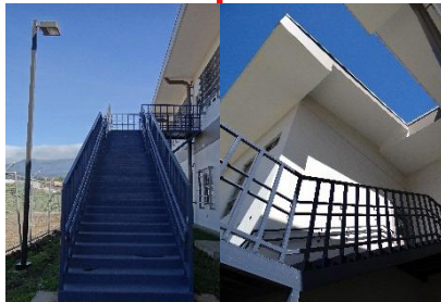
Img. 85 Escaleras de emergencia
