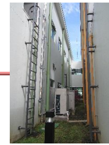
Img. 147 Área verde donde se accede a los tanques de agua caliente.
