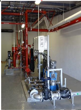
Img. 104 Sistema contra incendios y agua potable
