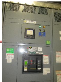
Img. 144 Subestación eléctrica
