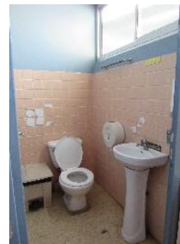
Img. 15 Servicios sanitarios
