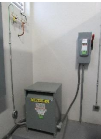
Img. 143 Puesta a tierra
