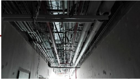
Img. 107 Conexiones eléctricas.
