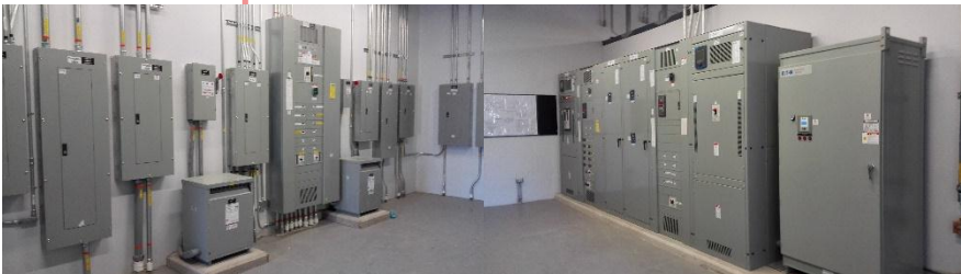
Img. 110 Casa de máquinas.
