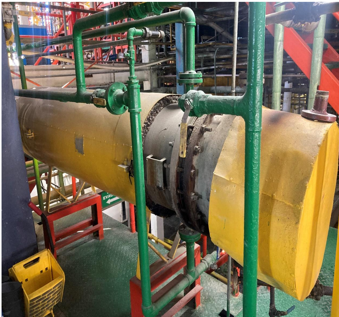
ANEXOS #7: Imagen del economizador #2 convertido en enfriador.
