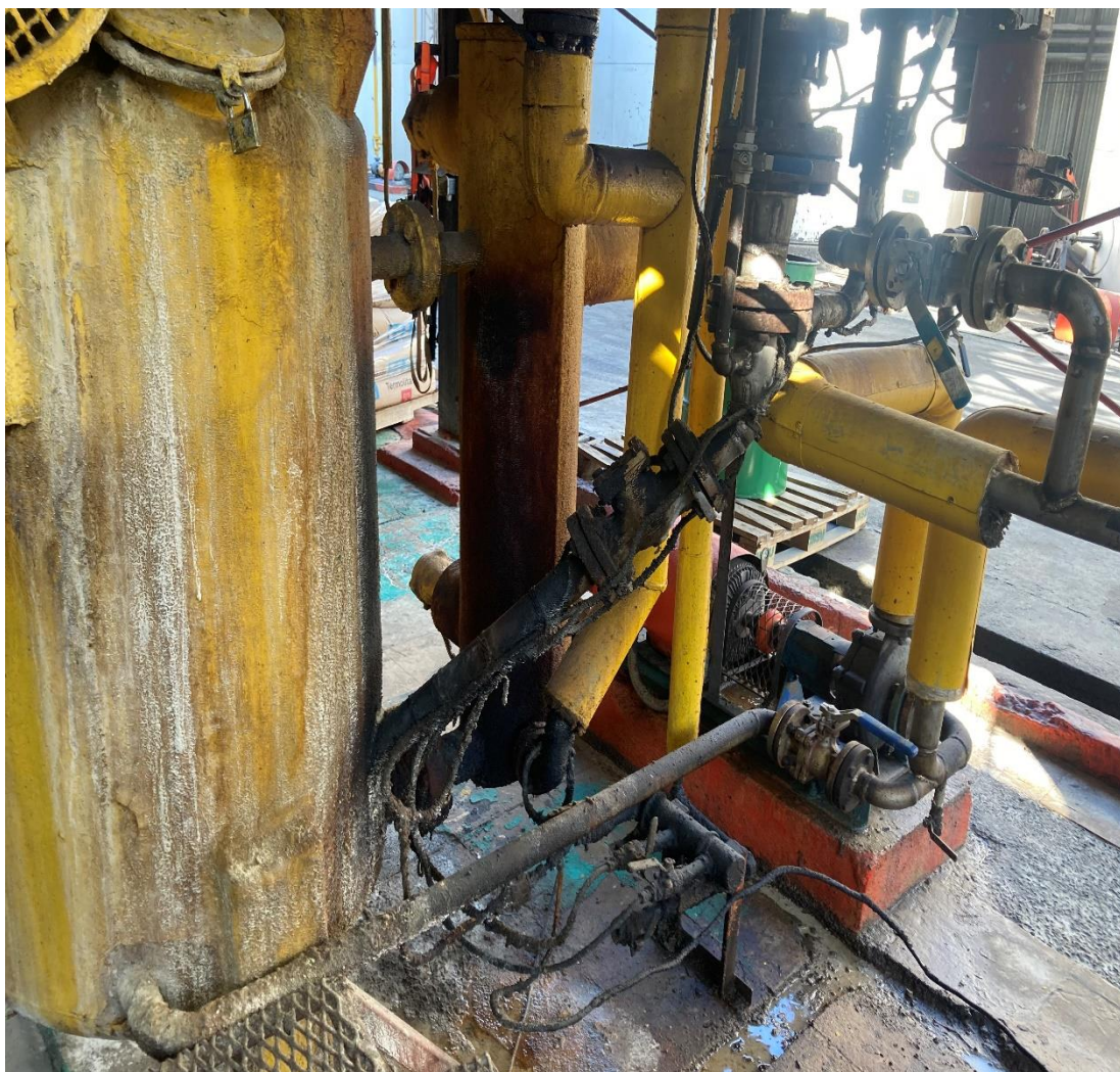
ANEXOS #8: Imagen de bomba industrial del 635 instalada.
