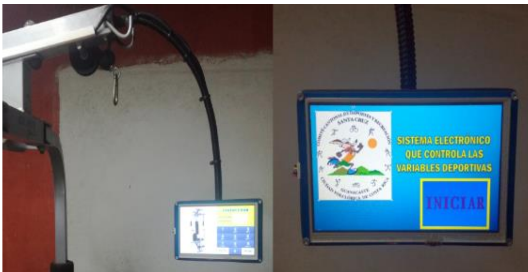
Figura 24. Pantalla Nextion instalada en la máquina de gimnasio.
