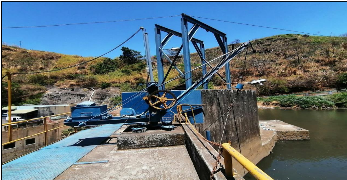
Imagen 8. Wincher Presa PH Belén.
