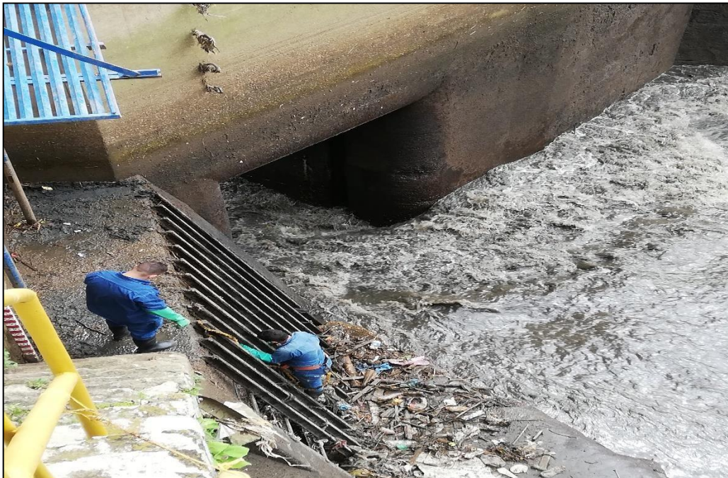
Imagen 4. Limpieza de parrilla gruesos con personal de CNFL.
