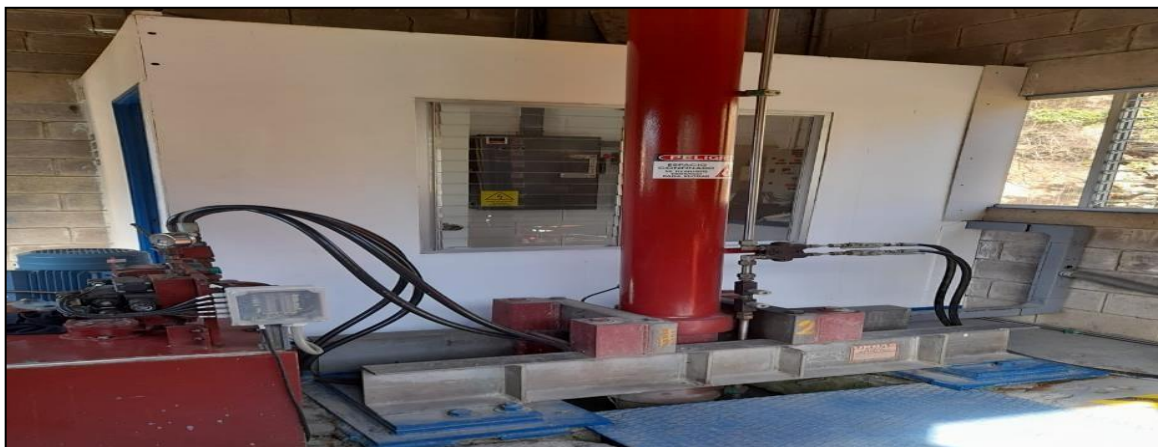
Imagen 2. Compuerta de regulación
