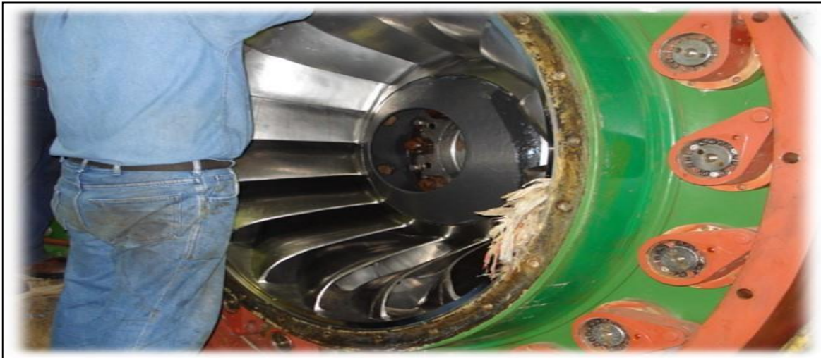
Imagen 8. Avería mecánica por basura en rodete unidad 3 PH Belén.
