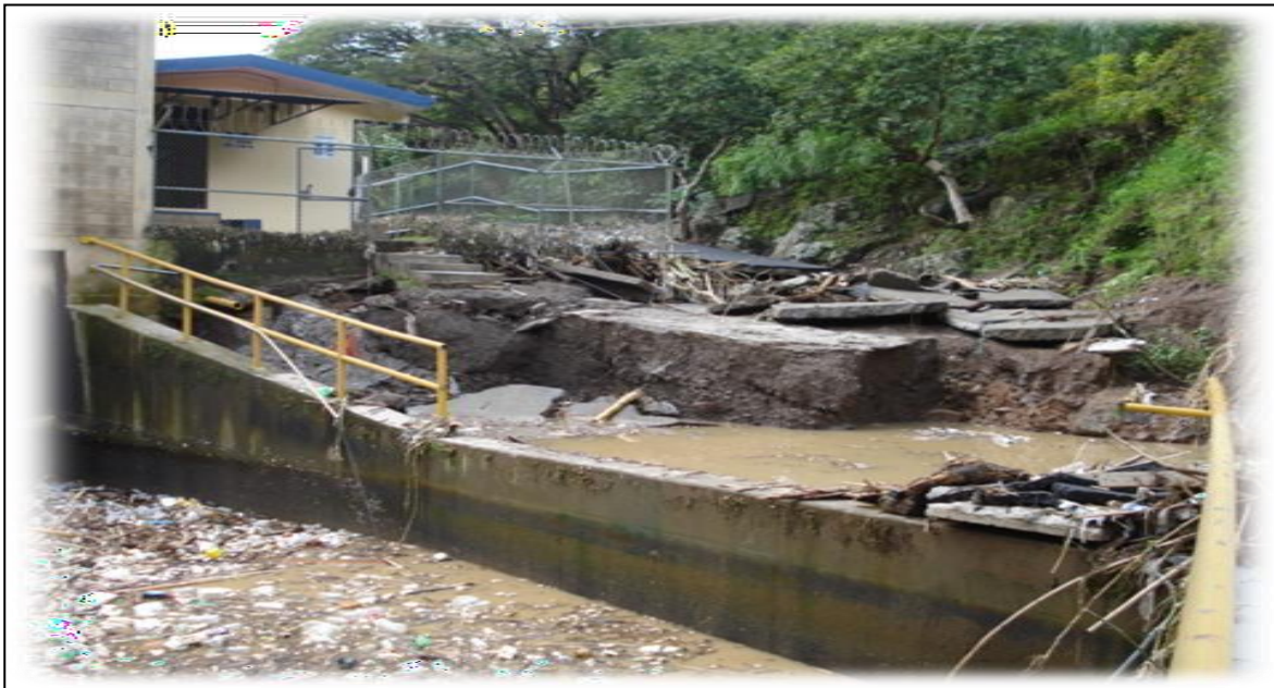
Imagen 9. Inundación Presa PH Belén.
