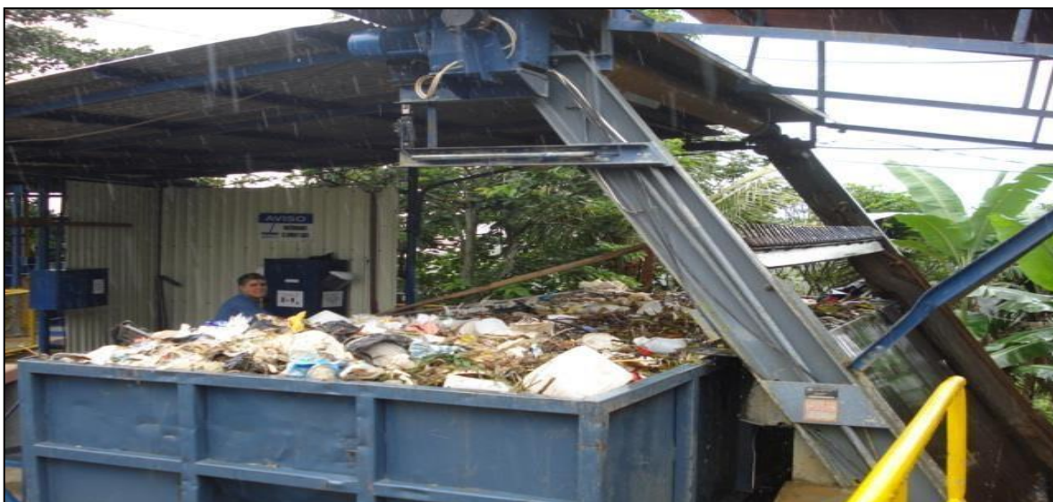
Imagen 7. Contenedor de basura tanque PH Belén.
