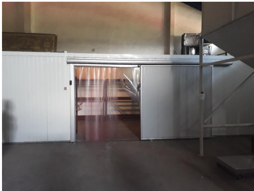
Cámara fría – Exterior
