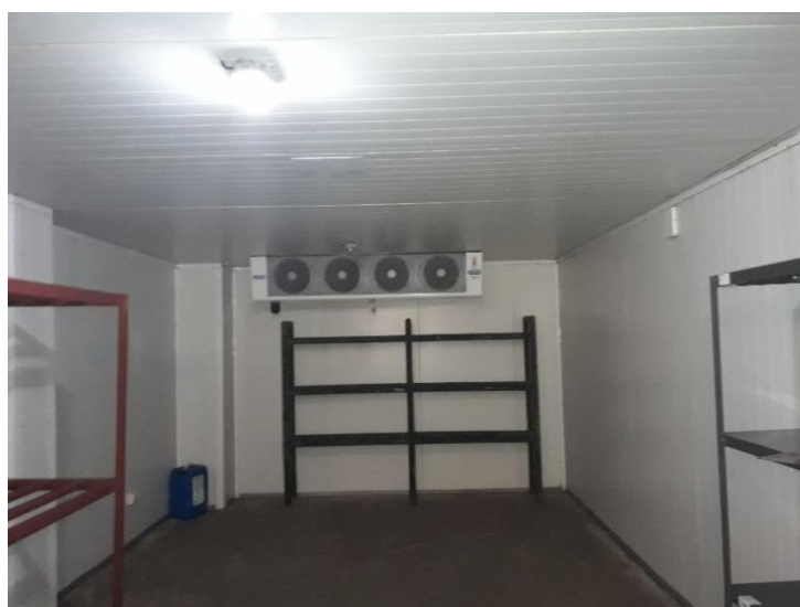
Cámara fría - Interior
