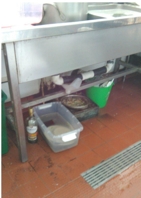
Figura N° 17: Mal estado del drenaje del fregadero y platos quebrados en un recipiente
