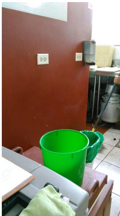
Figura N° 26: Dispensador de alcohol en gel dañado
