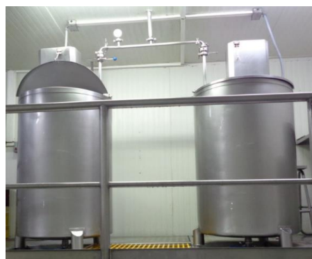
Figura 17. Tanques de salmuera
