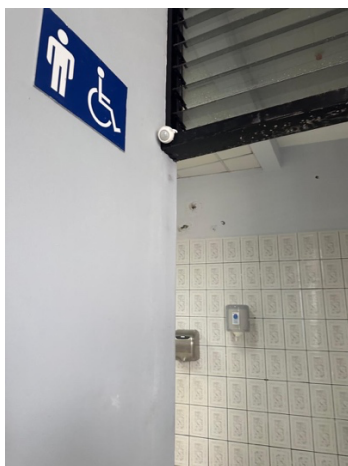
Figura 28. Sensores de movimiento en los baños de la universidad
