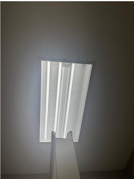
Figura 26. Luces led en los baños de la sede Heredia
