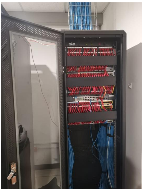
Figura 18: Rack Principal Oficinas Centrales Fuente: Departamento TI Rostipollos
