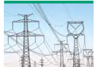
Figura 3.43 Línea de alto voltaje.
