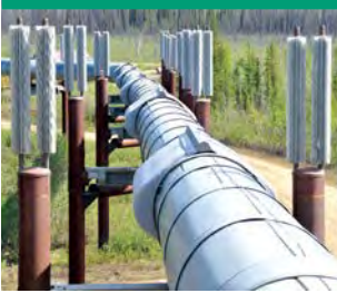
Figura 1.62 Detalle del oleoducto de Alaska, una de las más impresionantes instalaciones hidráulicas del mundo.
