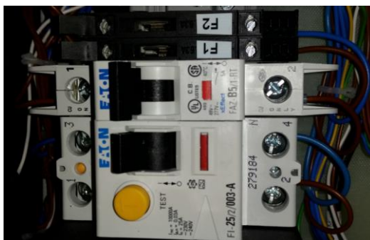
Figura 77. Disyuntores de protección y fusibles
