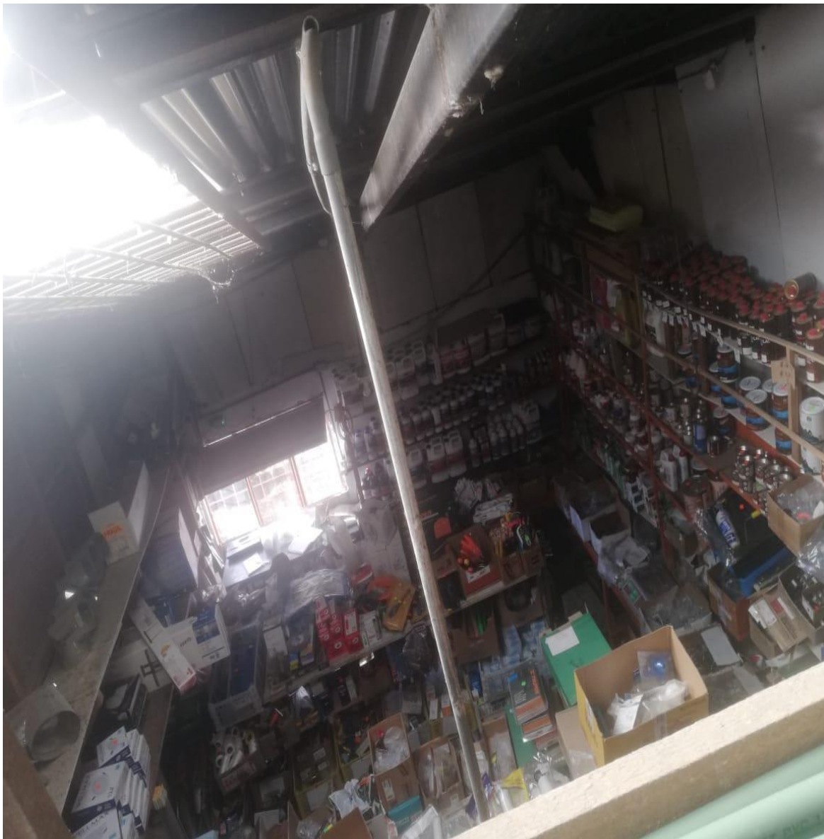
Figura 7. Estado actual de la bodega.
