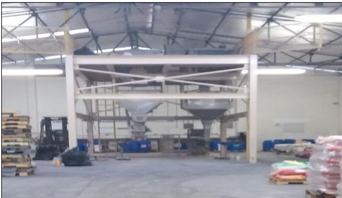
Figura 3 Maquinarias instaladas para la actividad
