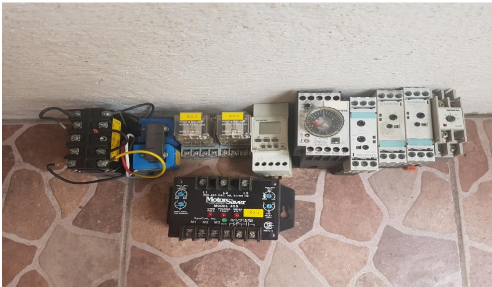
Figura 32. Componentes reemplazados en panel de control.
