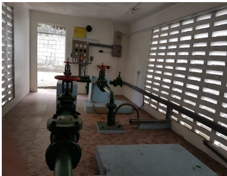
Figura 1. Vista de la estación de bombeo La Colina
