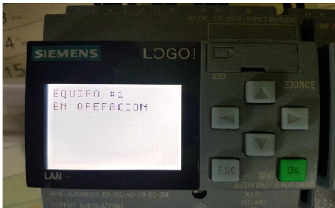
Figura 33. Activación de equipo 1 en el módulo de control.
