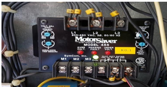
Figura 7. Relé de voltaje panel de control La Colina.
