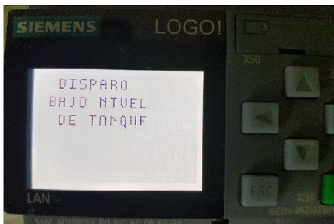
Figura 36. Aviso bajo nivel de tanque succión.
