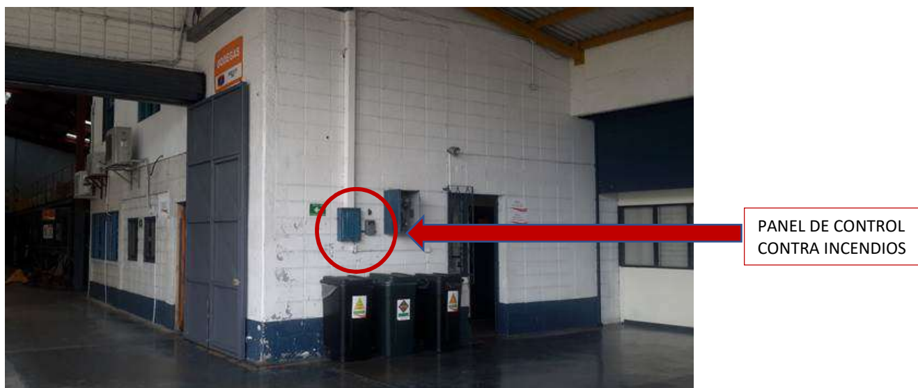
Figura N° 10 Panel de control contra incendios
