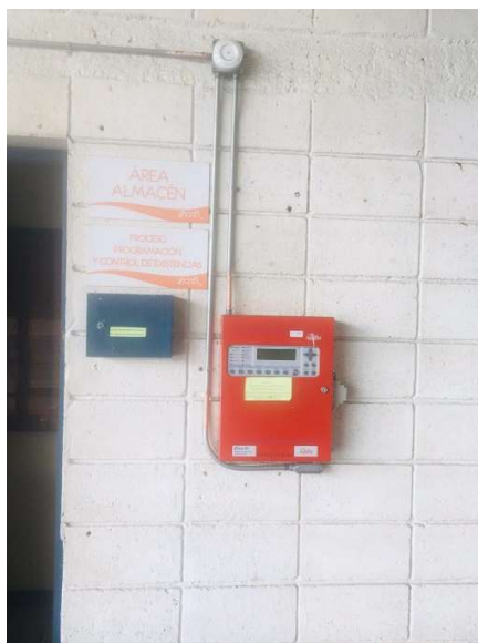
Figura N° 11 Alarma contra incendios
