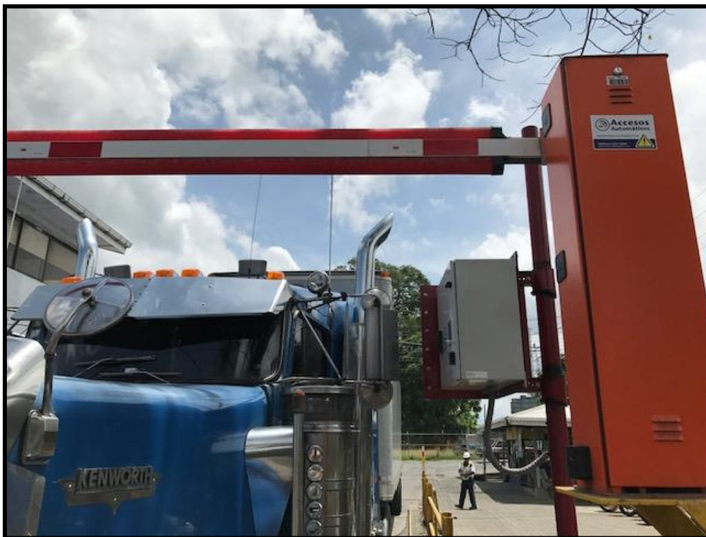
Figura 25. Agujas de acceso automático y kiosk de pesaje
