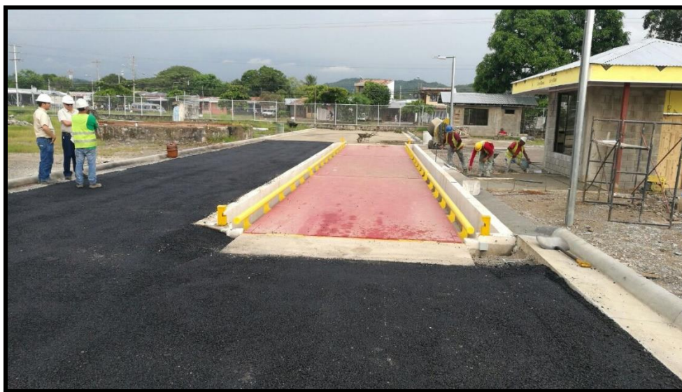
Figura 21. Nueva báscula camionera de ingreso de camiones
