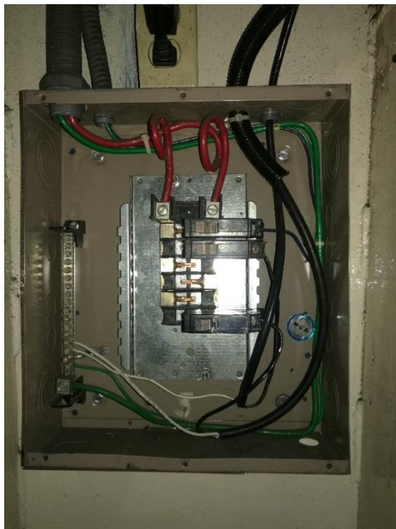
Figura 45. Conexión de la alimentación del panel de control. Fuente: El Autor.
