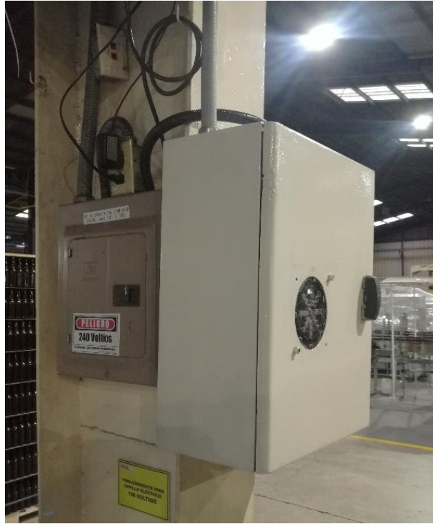
Figura 43. Panel de control situado en la planta de VICESA. Fuente: El Autor.
