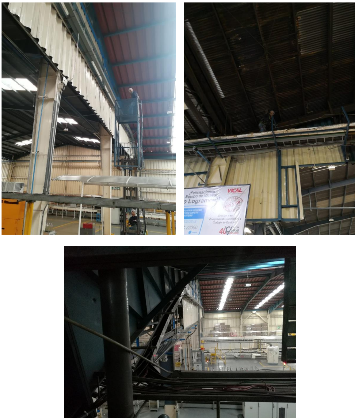
Figura 39. Cableado de señales H-200 y H-100. Fuente: El Autor
