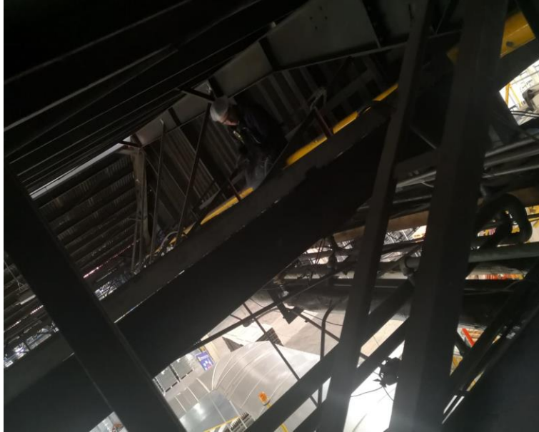
Figura 40. Cableado de señales Área de Decorado y Área de Embalaje.
