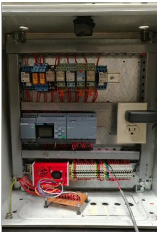
Figura 42. Panel de control terminado y conectado en el banco para pruebas.
