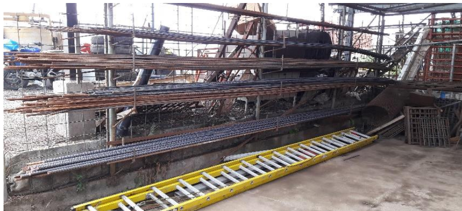
Ilustración 3 Acumulación de materiales en el plantel municipal.
