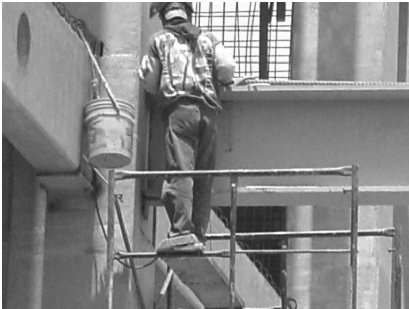
Figura 5.2. Los trabajos de altura generalmente resultan muy peligrosos
