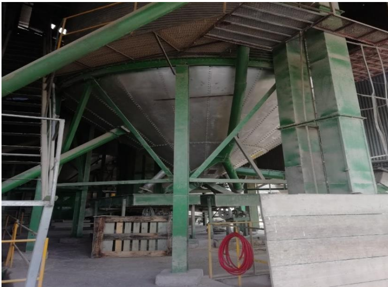
Figura 14 Silos de recibo
