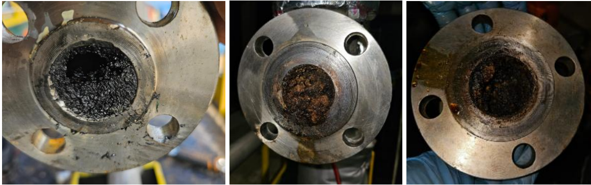
Figura 10 Hallazgos de obstrucciones en el sistema durante los paros para revisión y limpieza
