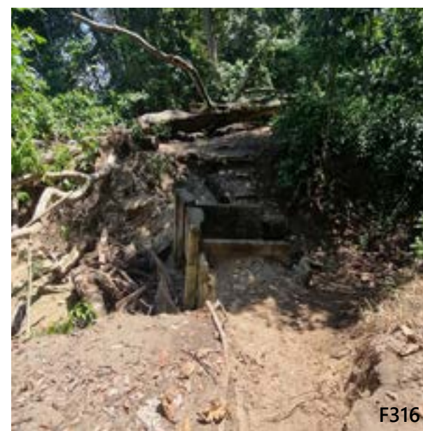
Puente peatonal destruido
