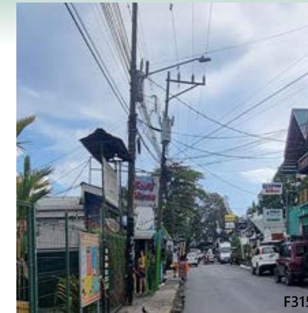
Tendido eléctrico aéreo
