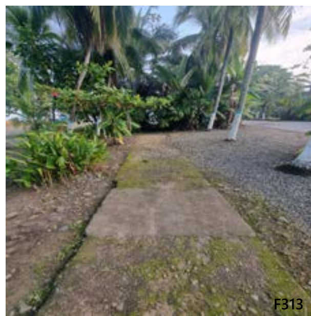
Acera en mal estado, sin continuidad
