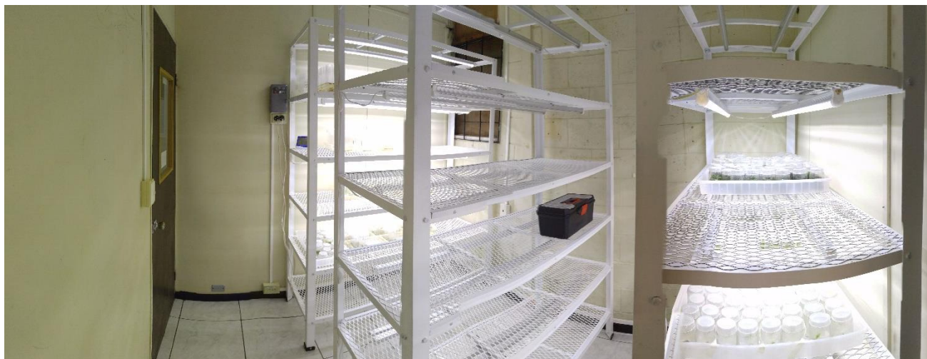
Figura 12. Cuarto de crecimiento del laboratorio de tecnología del CIGRAS después de remodelación
