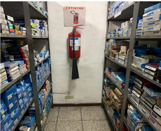
Figura 29. Extintor previo a metodología 5S
