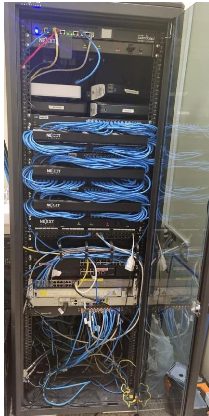
Ilustración 21, Rack principal de SJS
