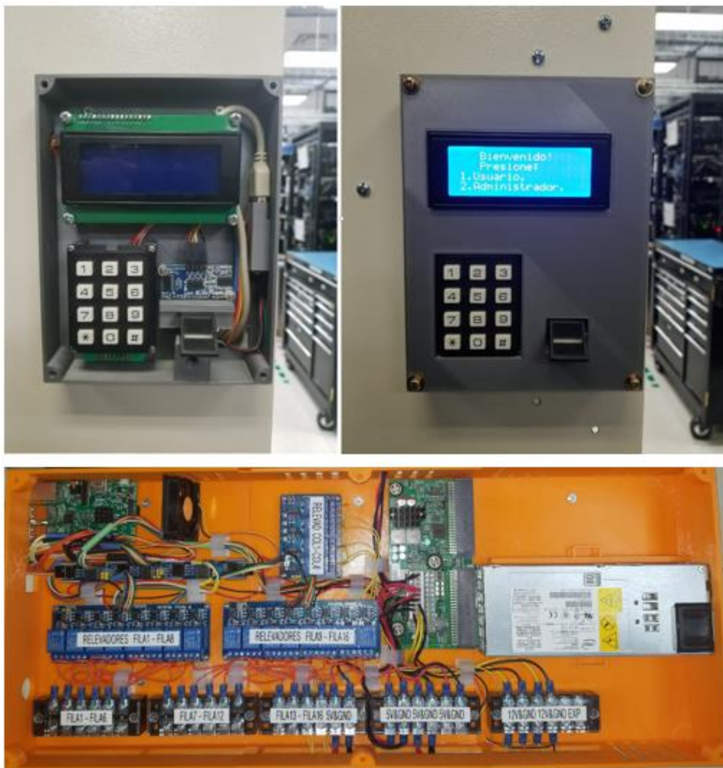
Figura 51. Caja principal y de control para CR DCG.
