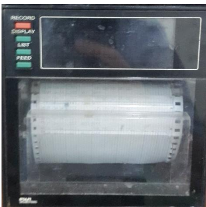
Ilustración 4: Dispositivo de registro de corriente (Máquina de Anodizado de Coopesa)
