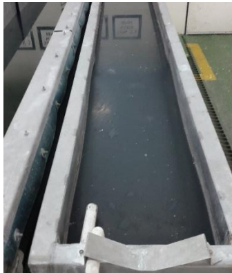
Ilustración 14: Tanque 6 (Lavado) – Coopesa
