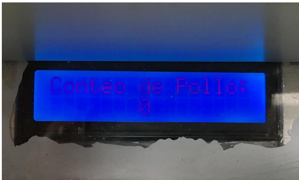
Figura 36. Pantalla LCD instalada.
