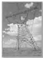
Líneas de alta tensión
