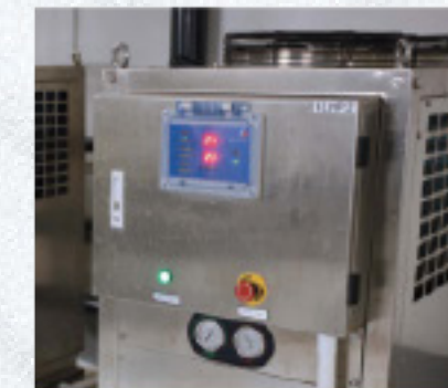
5. BOMBA DE TEMPERATURA
