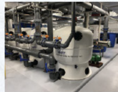
1. FILTROS DE ARENA
