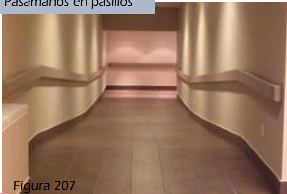
Pasamanos en pasillos
