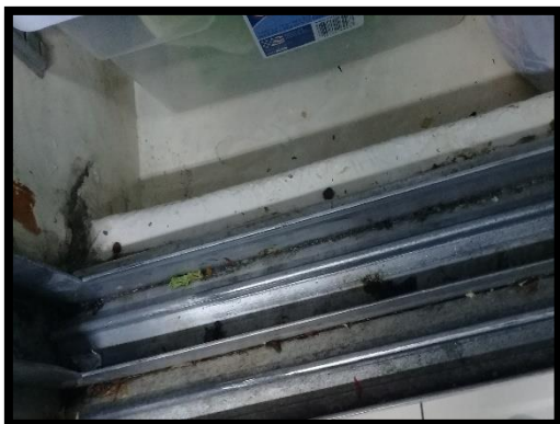
Figura N°7. Riel de la puerta de la cámara de refrigeración, Vigui 2017
