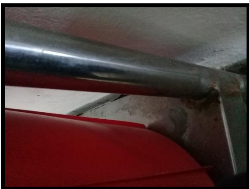
Figura N°12. Estado de los muebles de acero inoxidable del servicio de alimentos, Vigi 2017
