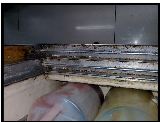
Figura N°6. Riel de la puerta de la cámara de refrigeración, Vigui 2017
