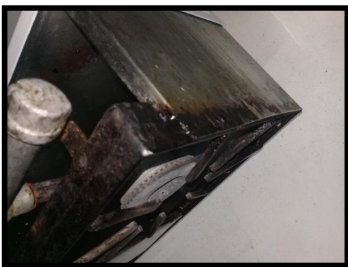
Figura N°14. Estado del equipo del servicio de alimentos, Vigui 2017
