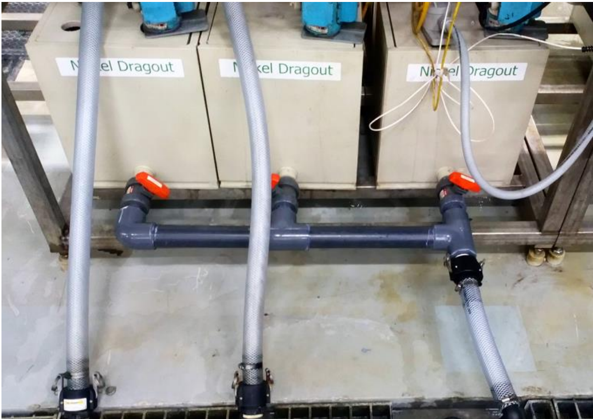
Ilustración 33. Tubería de drenado de Níquel 2 pulgadas
