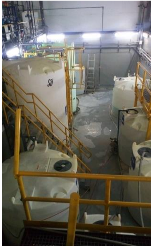
Ilustración 47. Tanques de almacenamiento de agua
