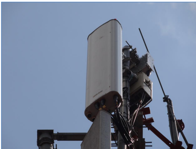
Figura 36. Instalación RRU y Antenna.
