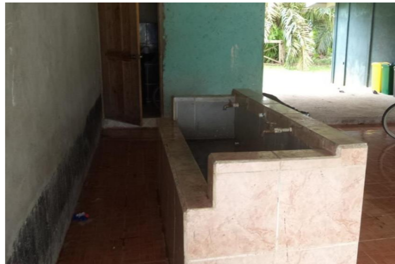
IMAGEN 12: Servicio Sanitario y lavamanos Fuente: Fotografía de la autora.(2015)
