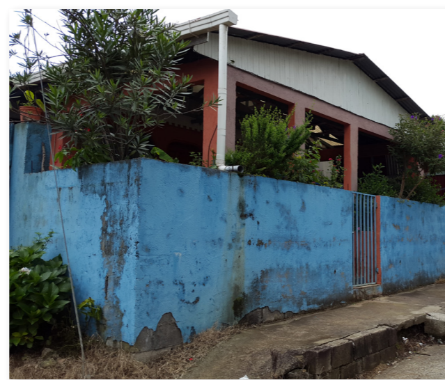
ACERAS EN MAL ESTADO
