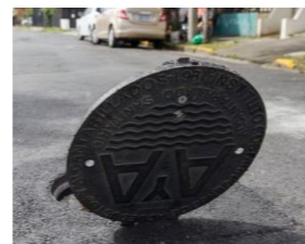
Acueductos y Alcantarillados
