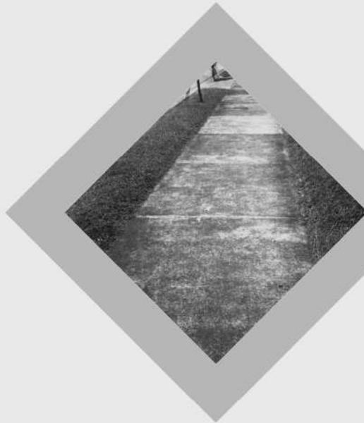
ACERAS ESTADO Y EXISTENCIA
