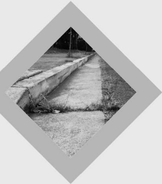
CORDON CAÑO ESTADO Y EXISTENCIA
