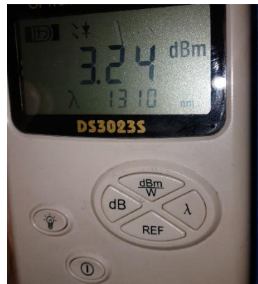
Figura 58: Medición de luz óptica atenuada en la salida del transmisor
