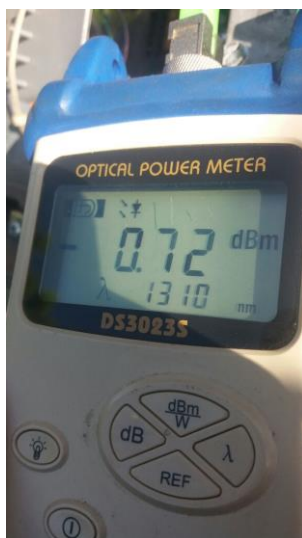
Figura 59: Medición de luz óptica en el nodo el cruce
