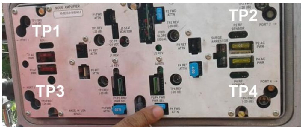
Figura 64: Núcleo del nodo óptico Instalado en el cruce
